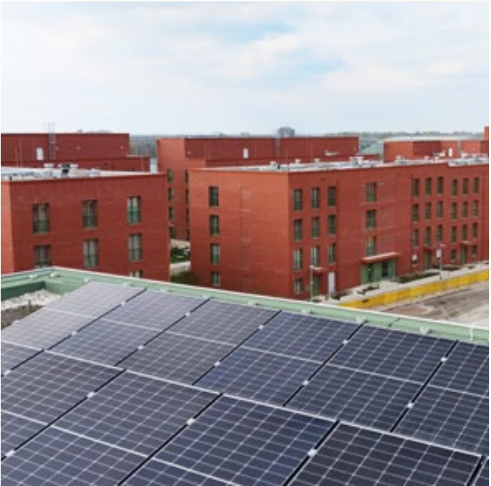
PV-Aufdachanlagen im GWH Quartier NordKrone
